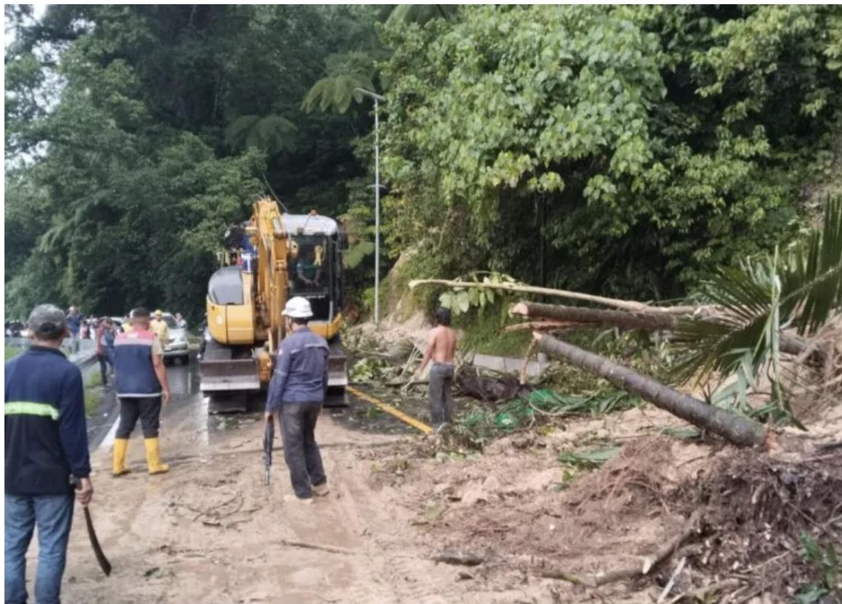
Material longsor menutup sebagian badan Jalan Padang-Bukittinggi di Kelok Banio, Padang Pariaman, Rabu (29/7/2026).
