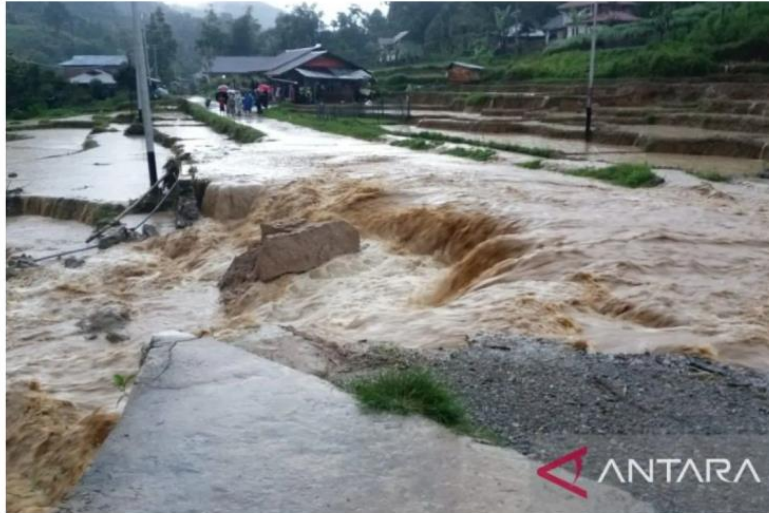
Kondisi jalan provinsi yang ambles akibat banjir di Jorong Tigo Kampung, Nagari Pagadih, Kecamatan Palupuh, Kabupaten Agam, Sabtu (10/1). Dok ANTARA/HO/Camat Palupuh
