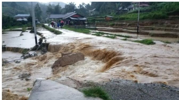
Kondisi jalan provinsi yang ambles akibat banjir di Jorong Tigo Kampung, Nagari Pagadih, Kecamatan Palupuh, Kabupaten Agam, Sabtu (10/1). Dok ANTARA/HO/Camat Palupuh
